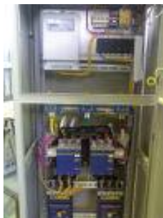
Рисунок 10 — Шкаф вводно-распределительного устройства
