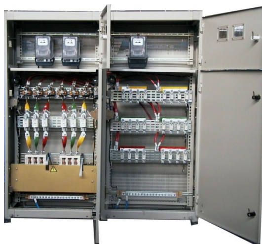
Рисунок 11 — Разделительные панели вводно-распределительного устройства
