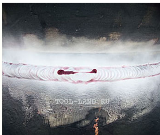
Рисунок 19 – Пример дефекта сварного соединения
