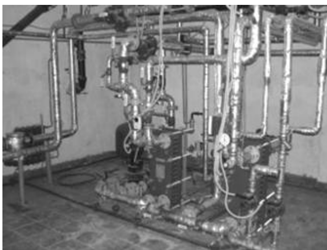
Рисунок 9 - Автоматизированный тепловой пункт
