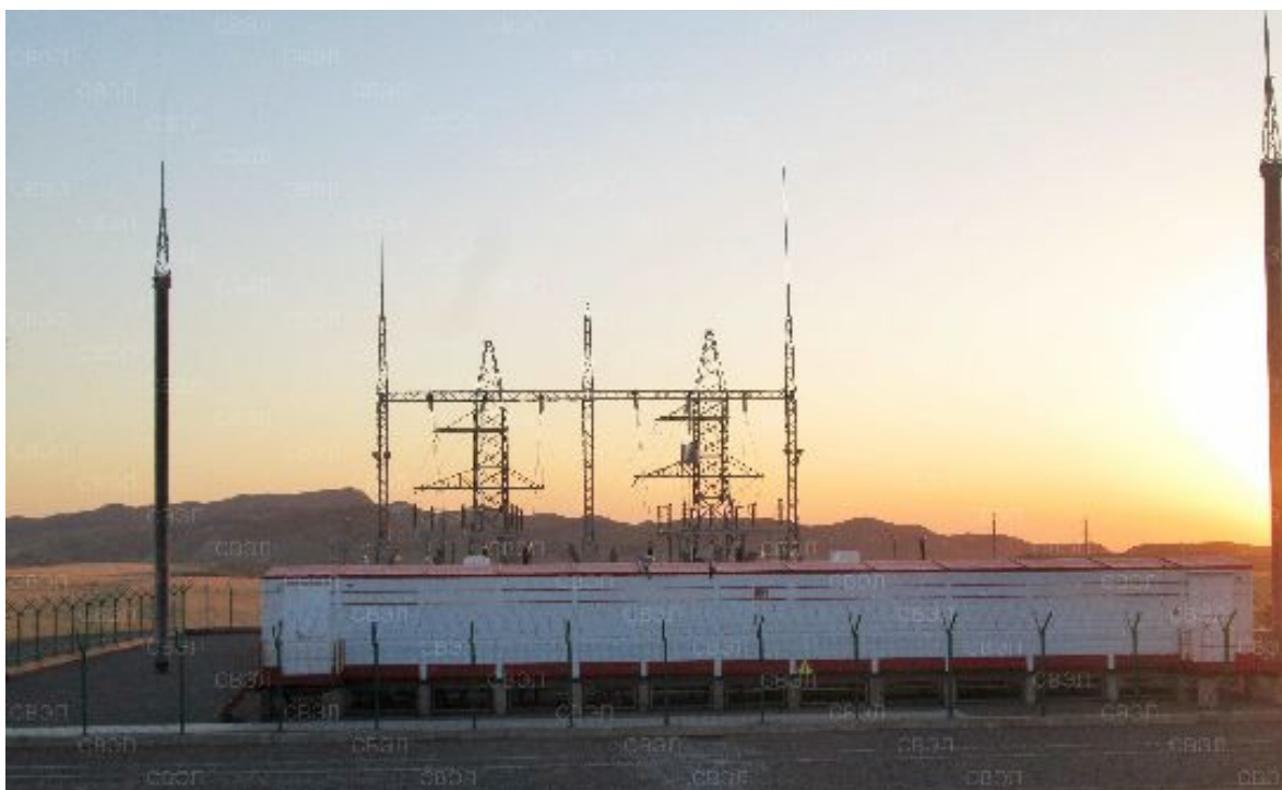
Рисунок 3 – Комплектные трансформаторные подстанции
